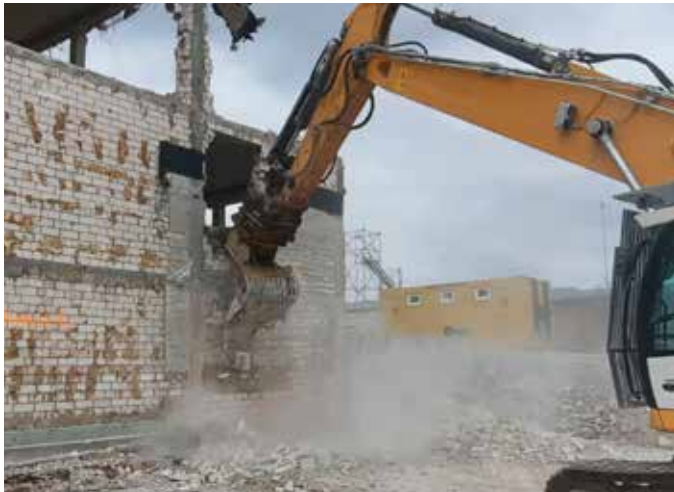
Das Kalksandsteinmauerwerk wird zunächst sortenrein von den übrigen Bauteilschichten getrennt und anschließend mechanisch abgebrochen.
