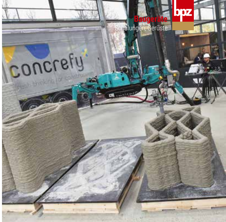
Der 3D-Baudrucker von Umdasch Group Ventures auf der bauma. Mit ihm ist die Fertigung von Betonstrukturen ohne Schalung möglich – in der Fabrik oder mobil vor Ort auf der Baustelle. Bild: Paul Deder
