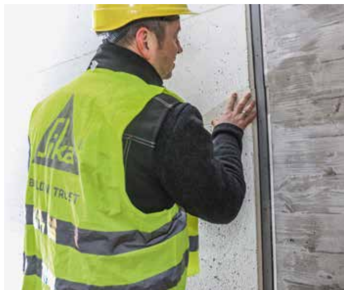
Die fachgerechte Abdichtung der Dehnfugen in dem Tunnel aus wasserundurchlässigem Beton wurde geprüft. Abgedichtet wurde mit den Fugenbändern Sika Waterbar.
