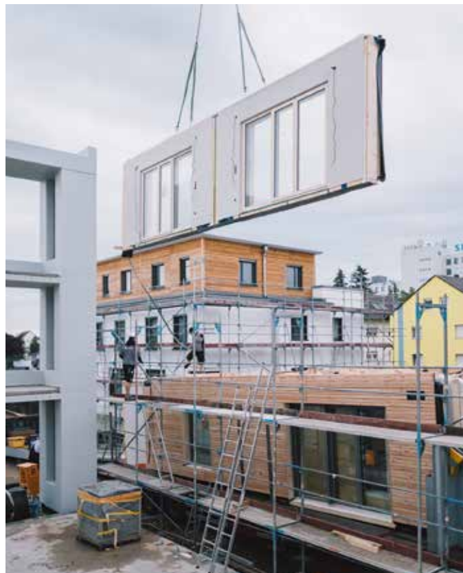
Für die Grobmontage eines der Mehrfamilienhäuser benötigt das Holzbau-Team in der Regel nur rund acht Tage und für die Detailausführungen noch einmal etwa 14 Tage. Bilder: Saint-Gobain Isover
