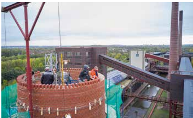
Schicht für Schicht wird der 80 m hohe Schornstein S4 mit den Radialklinkern von Wienerberger aufgemauert.
