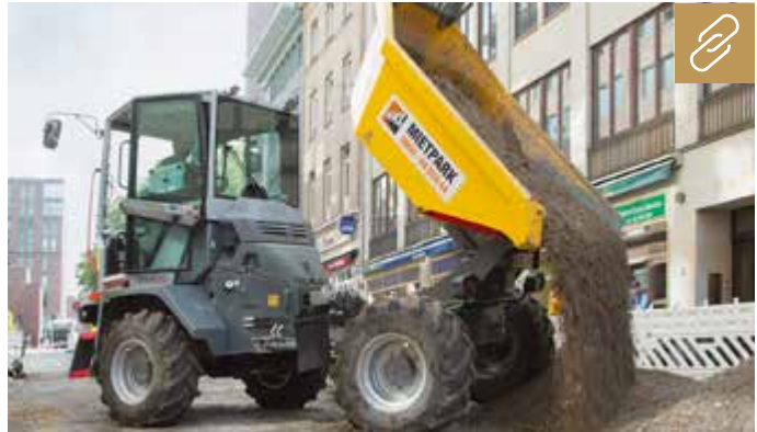
Bei Arbeiten im Abschnitt Rathausstraße übernehmen Dumper von HKL den Transport von Sand, Erde und Steinen. Bilder: HKL
