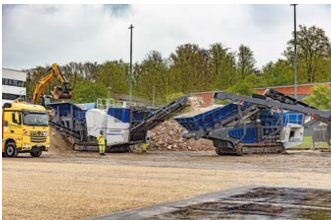
Für die Erstellung der Frostschutzschicht aus Mauerwerks- und Betonresten waren im Demo-Bereich die beiden mobilen Kleemann-Brecher MC 120i PRO und MCO 110i PRO im Einsatz.
