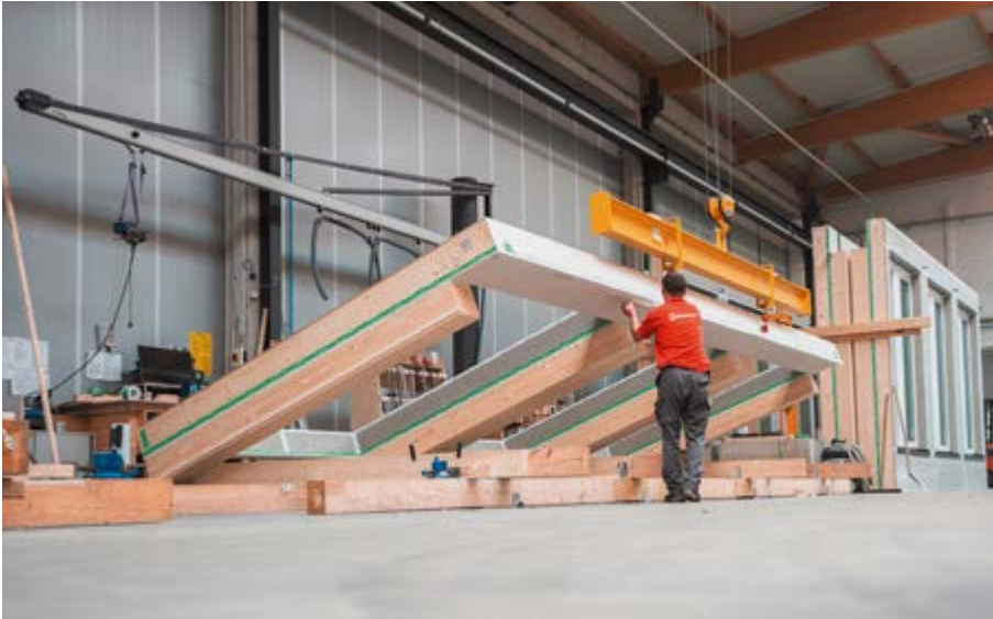
Sekundäre Außenwand, Stützen und Fenster werden von Brüninghoff als Elemente vorproduziert. Das sorgt nicht zuletzt für einen optimierten Baufortschritt.
