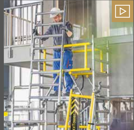
Die leichten Gerüstbauteile werden bei der Montage an ausziehbaren Einhängekonsolen der Plattform eingehängt und so von Ebene zu Ebene mitgenommen. Bild: Munk
