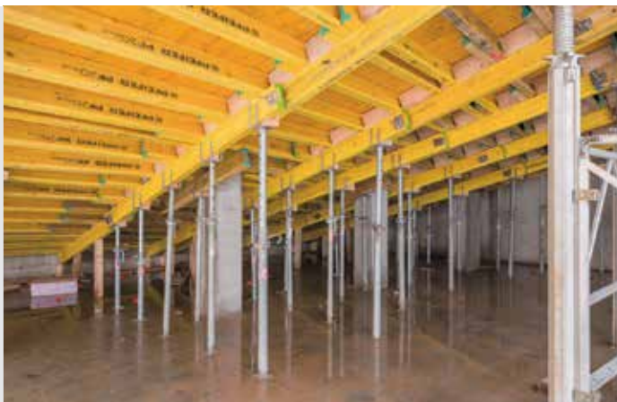
Die schrägen Böden der Hörsäle wurden mithilfe von Schaltafeln, H 20 Trägern und Euro-Deckenstützen betoniert. Hierbei nutzen die Baustellenmitarbeiter, dass sich die Deckenstützen in der gewünschten Höhe einstellen lassen.
