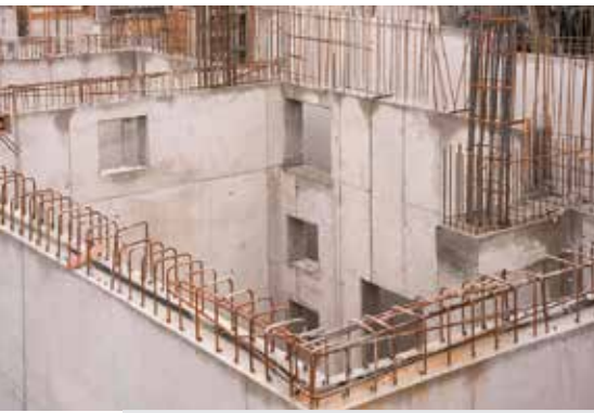
Der Rohbau stellte die Verantwortlichen vor knifflige Aufgaben, die sie mithilfe sNoe meisterten.
