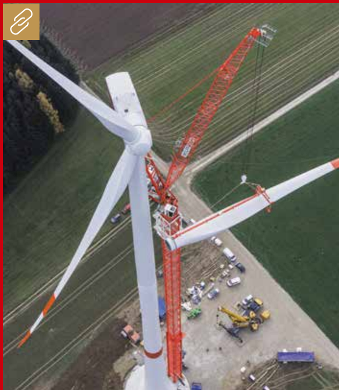
Obendreher und Windräder beanspruchen am Boden nur wenig Platz, hier ein Wolff-Wipper in patentierter Bauart mit Verbindungsbock und aufgelöstem Fachwerk von Turmspitze und Gegenausleger. Bild: Wolffkran
